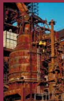
Usine sidérurgique Solmer, équipement anti-pollution : traitement primaire des gaz sur le haut fourneau 1, photographie de Jacques Windenberger, 72Fi 38/35 © Conseil Général 13 - Archives Départementales.
